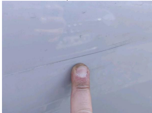
Slika R04-1: Vdolbina in poškodba laka
