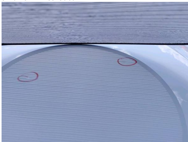
Slika R07-1: Poškodba
