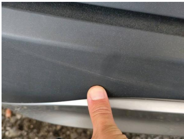
Slika R05-1: Poškodba
