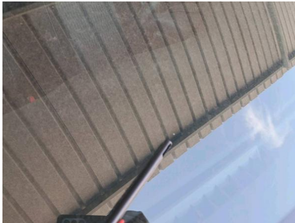
Slika R14-1: Poškodba
