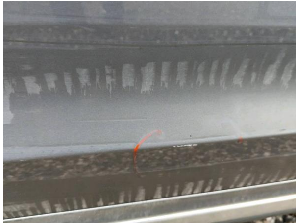
Slika R06-1: Poškodba laka
