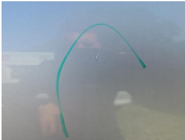
Slika R07-1: Poškodba laka
