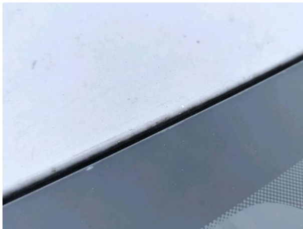
Slika R23-1: Poškodba
