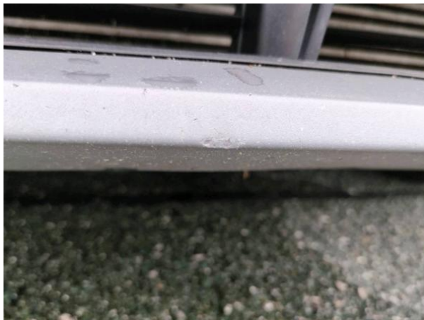
Slika R06-1: Poškodba
