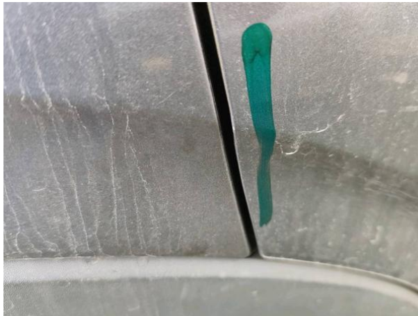
Slika R08-1: Poškodba
