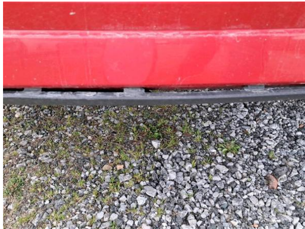
Slika R07-1: Poškodba
