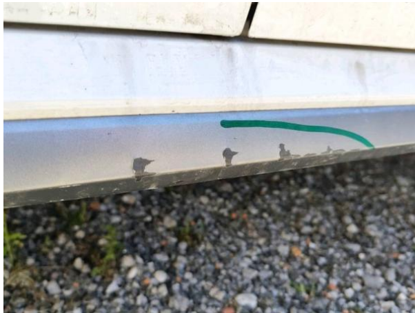
Slika R06-1: Poškodba laka
