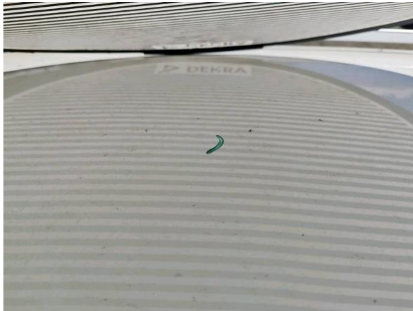
Slika R07-1: Poškodba
