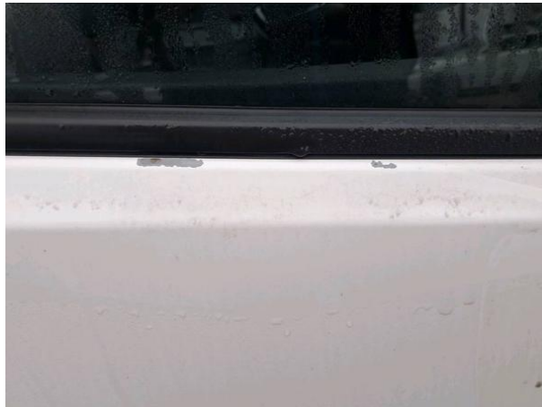
Slika R16-1: Poškodba laka
