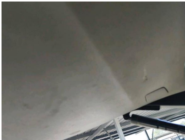
Slika N07-1: Poškodba
