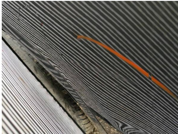
Slika R20-1: Poškodba
