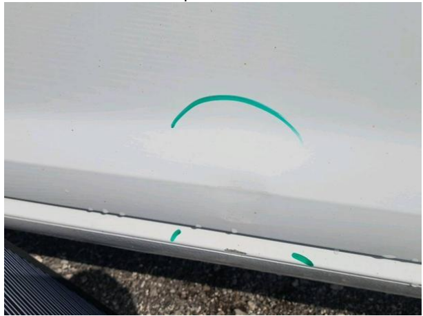
Slika R06-1: Vdolbina in poškodba laka
