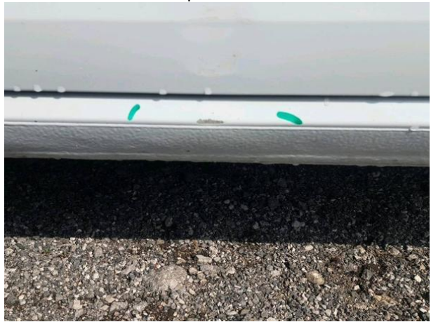
Slika R07-1: Vdolbina in poškodba laka
